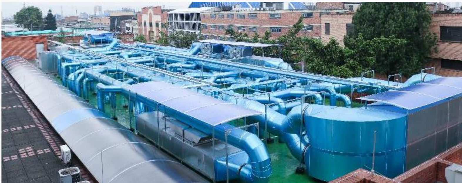
Finalización del proceso de montaje e implementación de la Sala Blanca GMP.
